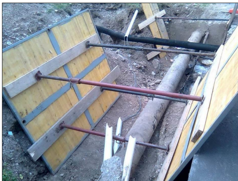
Esempio di armatura lignea vincolata da intelaiatura metallica. Notare la presenza di puntelli superiori ed inferiori, nonché degli assi ripartitori
