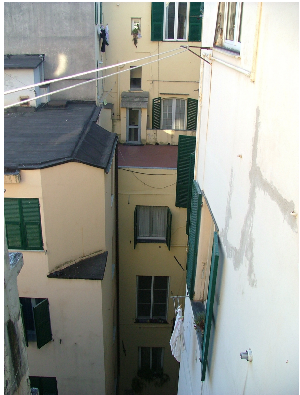
Corpi NN. 4 e 5 dal distacco interno
