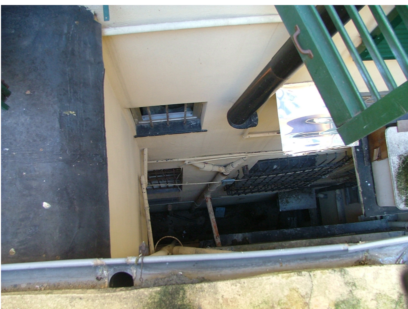
Distacco tra il corpo N.5 e Palazzo Granello con vista dall'alto della passerella di collegamento tra gli stessi
