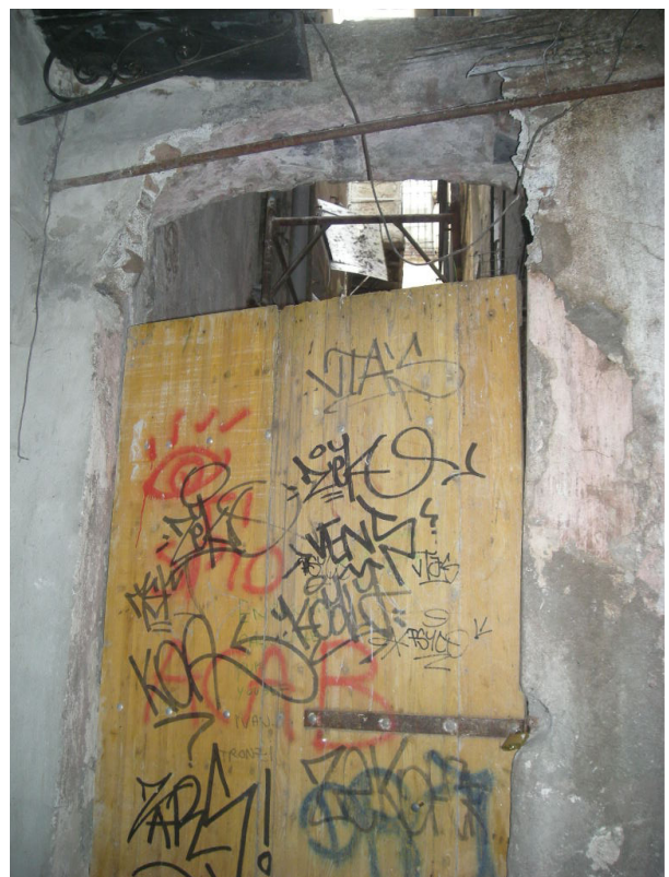
Tamponamento distacco tra il corpo in esame e il corpo di cat. "b"
