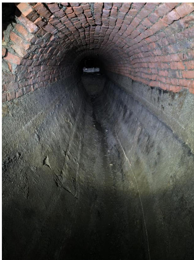
Fig.8 rio Bercilli – pulizia del tratto tombinato compreso tra sottopasso e via Walter Fillak
