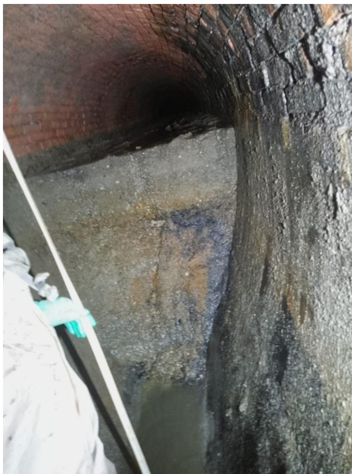
Fig.5 rio Bercilli – particolare dello strato di sedimenti presenti all'interno della tombinatura
