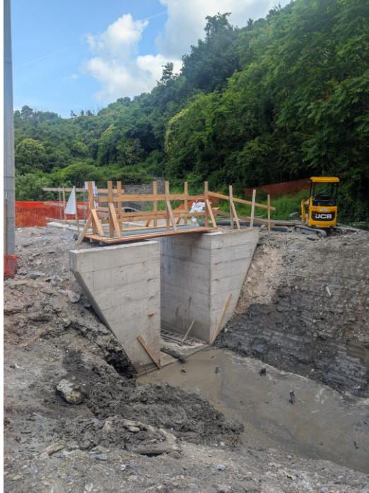
Fig.6 rio Zella – particolare del collegamento tra il tratto a cielo aperto del rio con il pozzo di caduta
